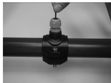
Figure 24 : Pose de la sonde de température sur le porte-sonde.
